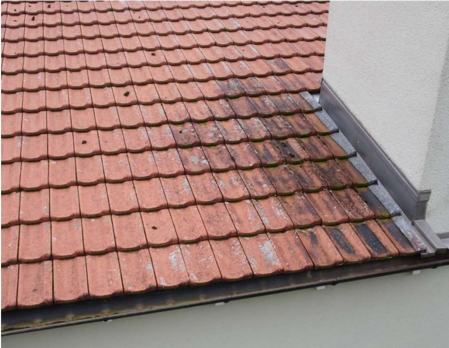
Foto: Moosbewuchs und Oberflächenverschmutzung
